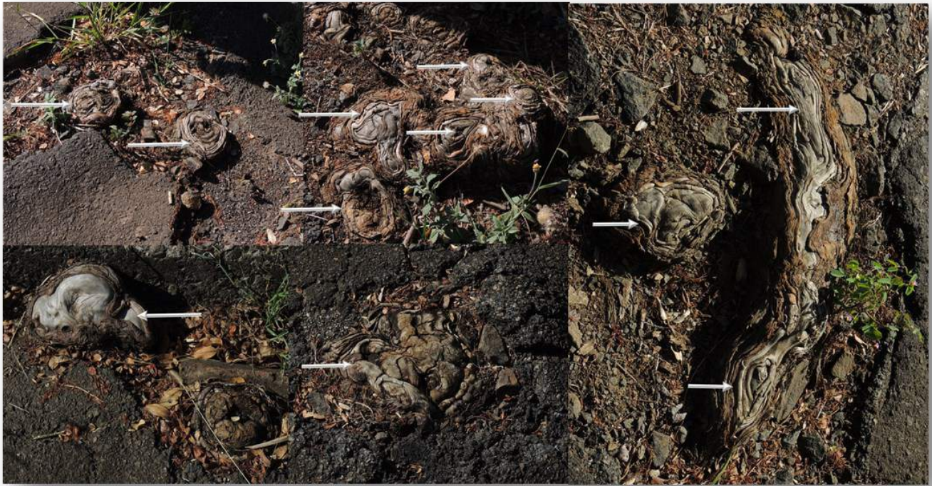
Figura 48 — Detalhe dos pneumatóforos (setas) rompendo o asfalto
